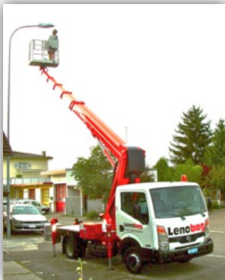
Kommunal abgestützt, innert 1 Min. arbeitsbereit
